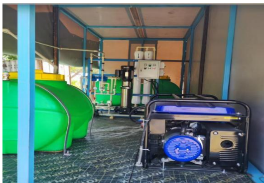
Рисунок 3- Мобильная опреснительная установка вид изнутри
